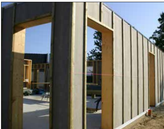
1. Der er monteret klemlister uden på vindspærren, og samtidig er udluftningsprofil og kantprofil monteret.
