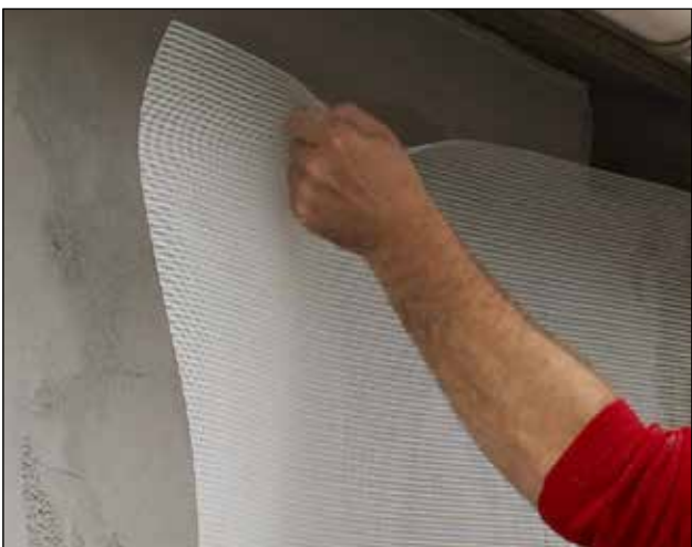
15. Skaltherm Grundpuds trækkes på med stålbræt, og nettet lægges i den våde Grundpuds.
