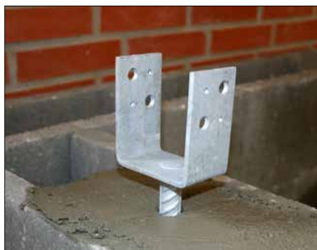
1. STØBNING: Emnet placeres i støbehullet og grovbetonen komprimeres omkring emnet. Mindre emner placeres i klargjort grovbeton.
