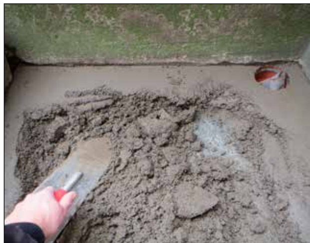
2. Den opblandede reparationsbeton påføres med spandeske eller lign. og trykkes godt på plads.
