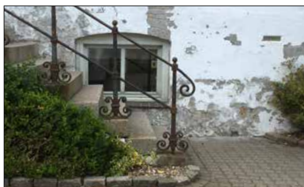
Ovenstående er eksempler på opstigende grundfugt. Ved højt vandtryk kan fugten vandre helt op til mandshøjde.
