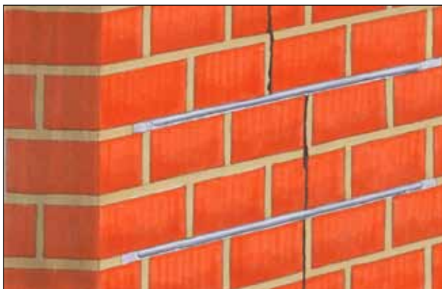
Sætningsrevner sikres med Skalflex Armeringssystem.
